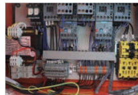
Cuadro eléctrico de alta calidad.
